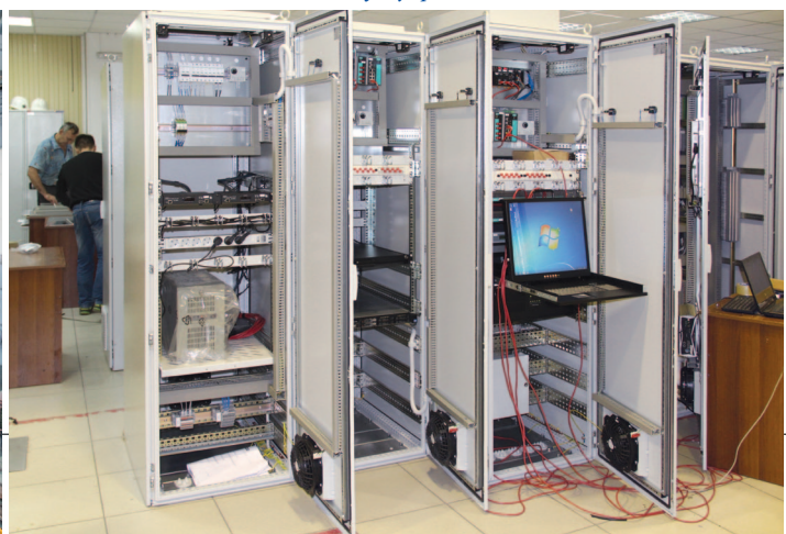
Шкафы управления для Гоцатлинской ГЭС
